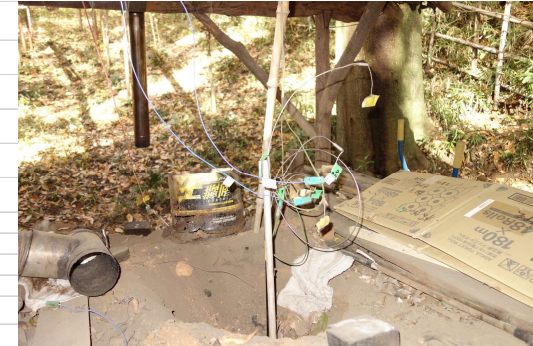
SUSガイド管と熱電対 上部よりの挿入状態
