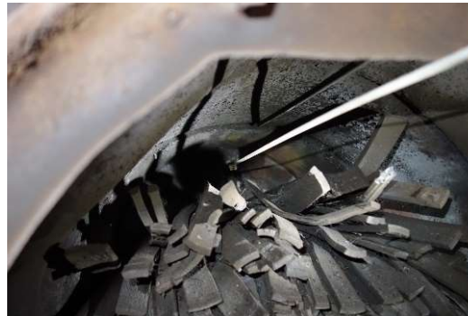
熱電対位置 管理 前面蓋から600mm奥まで挿入、 ほぼ窯の中央部
