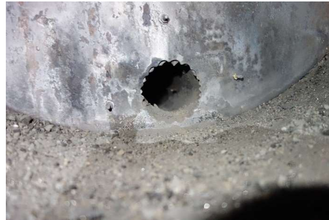
煙道入り口のレンガ高さまで炭化物が蓄積していた
